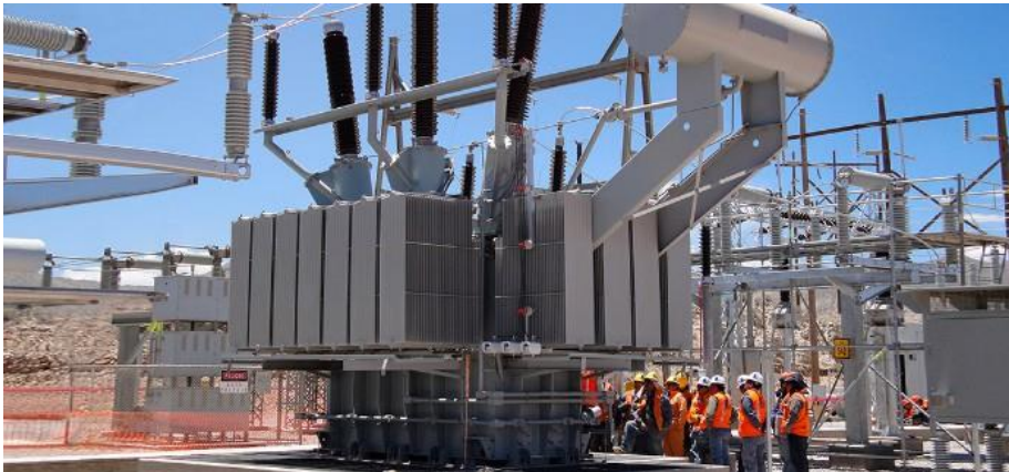
Transformadores de potencia de una subestación eléctrica
