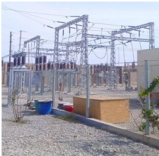
Subestación eléctrica de distribución
